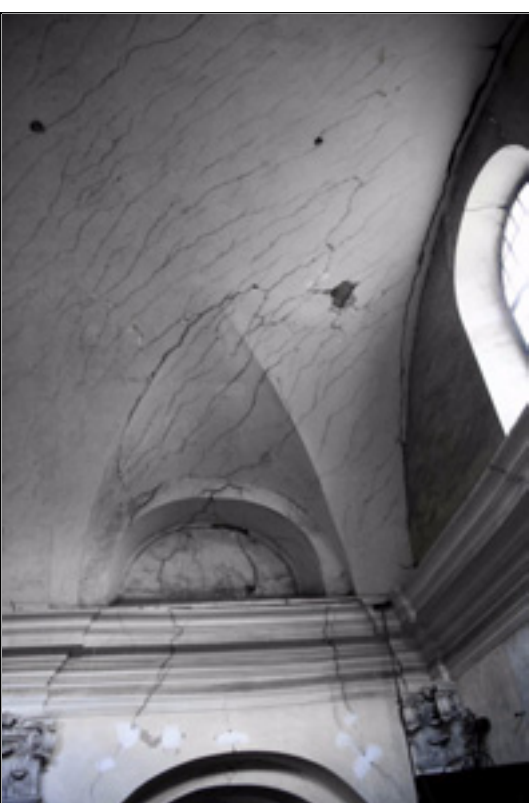
Popraskaný strop v "Jáně" foto jš
