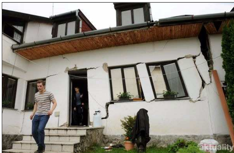
Poškozený domek v Nižné Myšli redakční archiv
